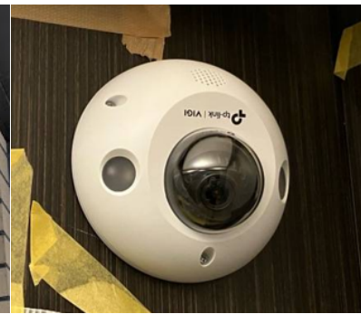
エレベーター内の監視用 「VIGI C230I Mini」
